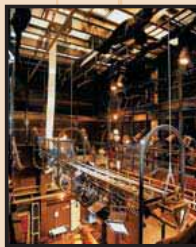
Blick aus dem Bühnenturm über die Technik zur Bühne
